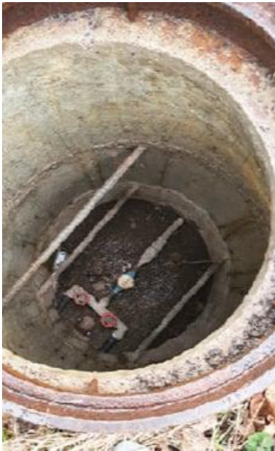
Figur 8 Exempel på ej godkänd montering av vattenmätare i mätarbrunn. Vattenmätaren är inte monterad i vattenmätarkonsol och dessutom för nära brunnen botten.
